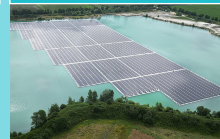
Centrale photovoltaïque flottante
