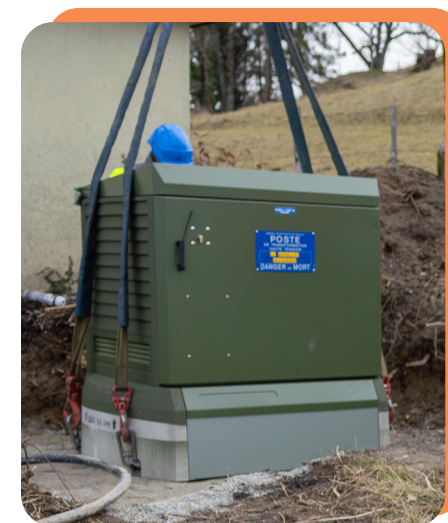
Poste de transformation moyenne tension
