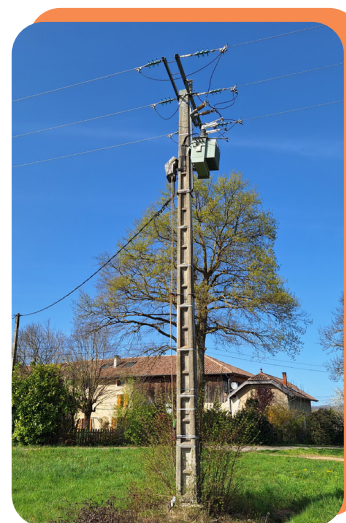
Poste sur poteau permettant de transformer la moyenne tension en basse tension.
